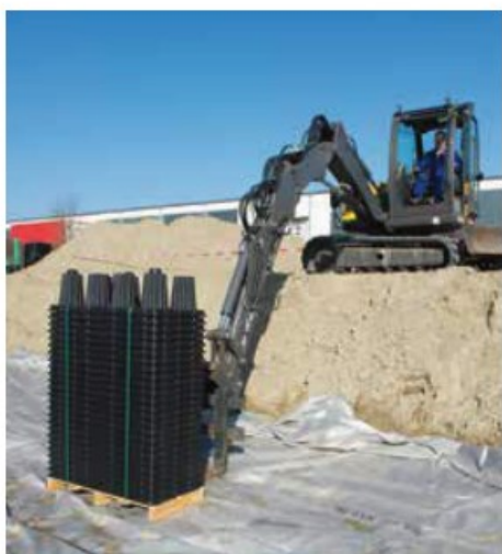
Vereenvoudigde opslag, handling en logistiek
